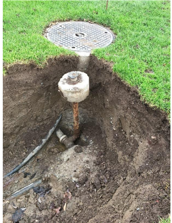
Abb. 3: Leitungen unter Hauptfeld; schlechter Zustand der Bewässerungsanlage.
