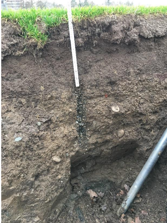
Abb. 2: Pflegehorizont und darunter stark zersetzte Rasentragschicht mit zu tief liegenden Drain-Schlitzten.
